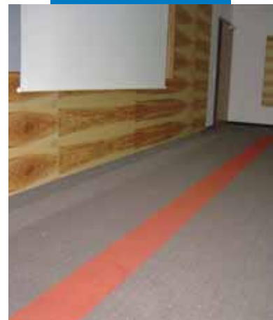
Пример использования Primer G перед нанесением Ultraplan Eco и клея Rollcoll для укладки коврового покрытия в номере отеля - Villa Hotel Castellani - Австрия
